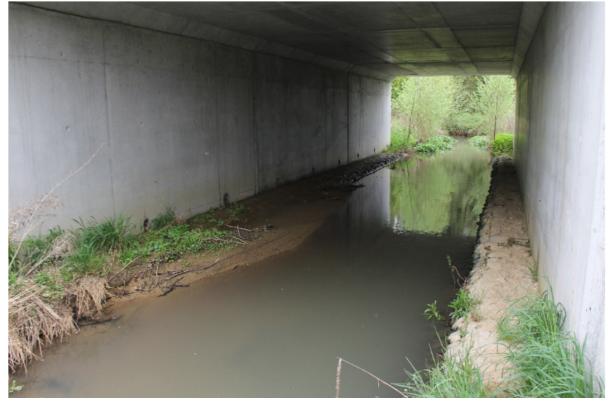
Pente trop faible (mauvaise répartition amont-aval)
