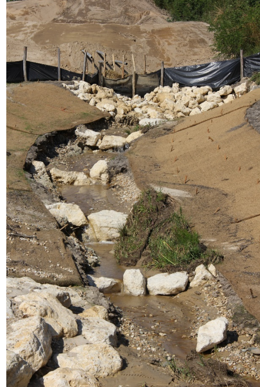
Discontinuités entre les blocs, incision, obstacle...
