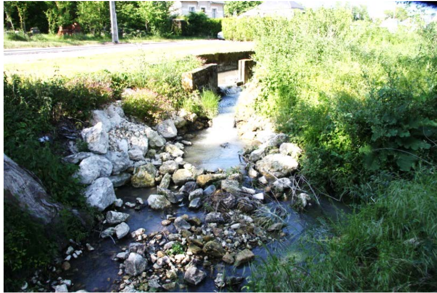
Pente trop forte + contrainte latérale (effet spray)
